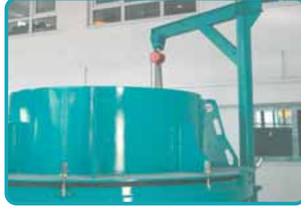
Maintenance Crane Bakım Vinci
